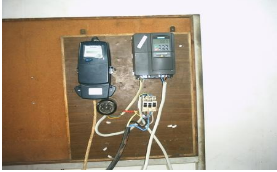
Şekil 11. Tri-Faze Elektrik Sayacı ve Elektronik Varyatör
